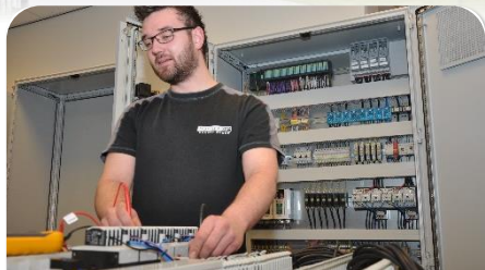
Herstellung von Schaltschränken
